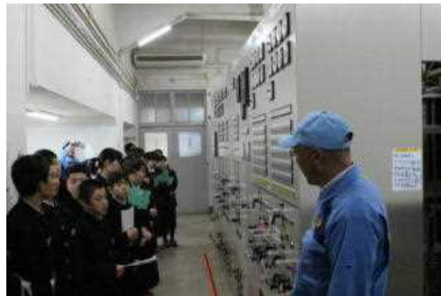
配電盤室の説明と見学③
