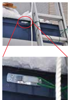
はしご固定金具の設置例
