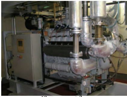
ガスエンジン
