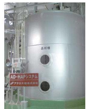
リン回収設備
