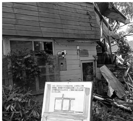
■雪で崩壊した宿泊施設
