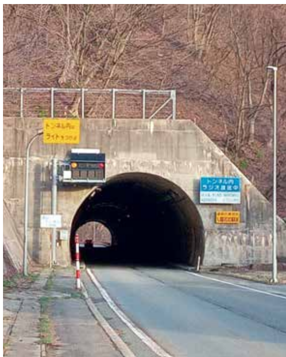
■トンネルの老朽化が進んでいる仙岩峠
