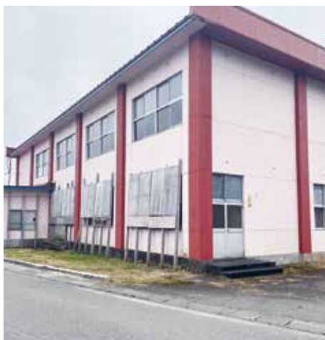
■落雪等の安全対策が必要な 旧西木公民館
