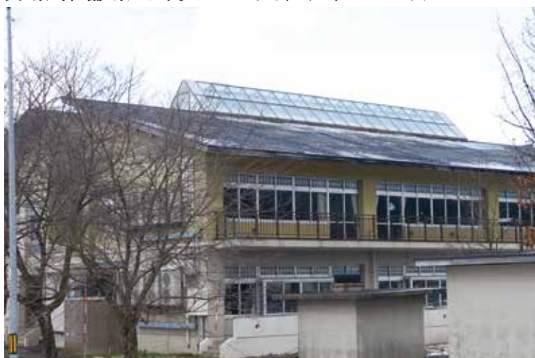
■ 6箇所の雨漏りが確認されている白岩小学校のガラス屋根
