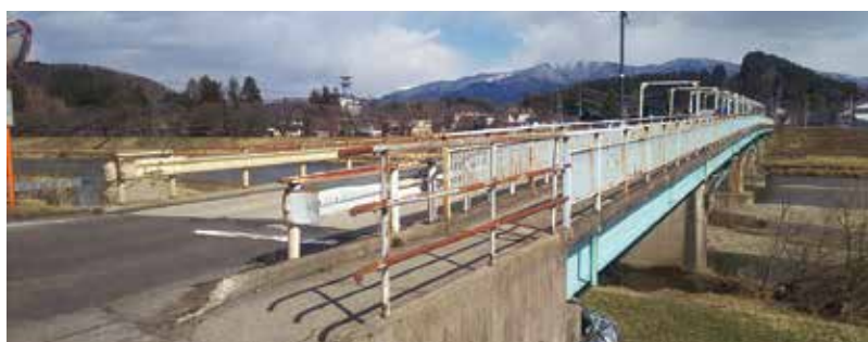
■老朽化が進む内川橋。早急な改修を求める。
