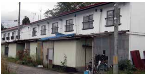
■老朽化が進む市営住宅
