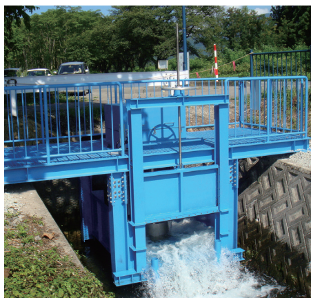
■小水力発電の実験の様子（黒倉若松堰）
