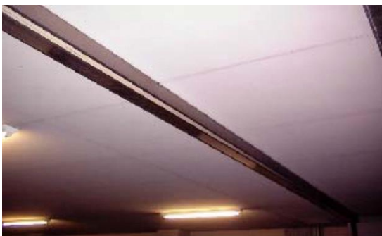
アスベスト含有天井材 (けい酸カルシウム板)
