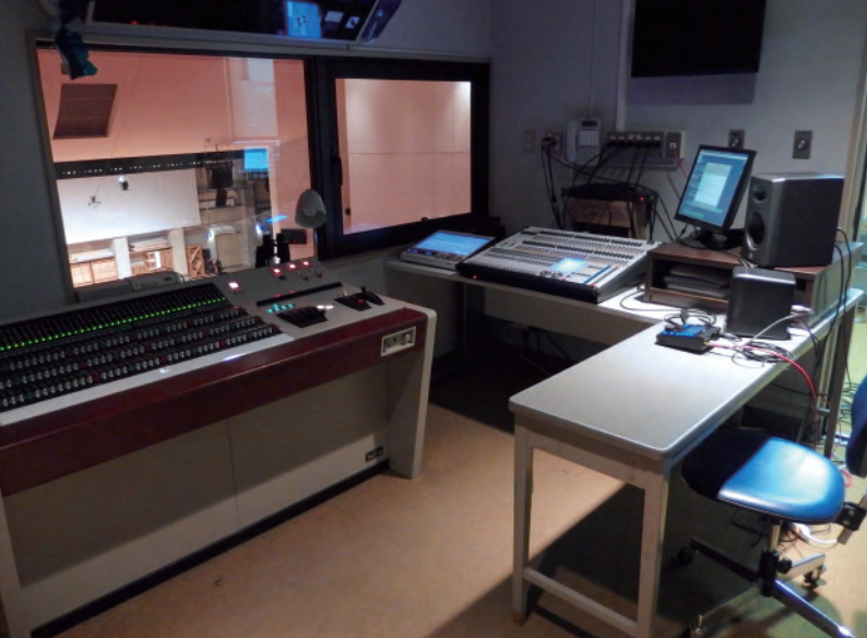
調光室 Lighting Room
