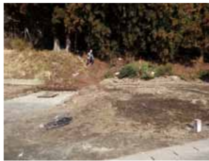
高台道路の路線測量センター杭設置の立会い、奥の山に向かって道路新設予定です。(山田町船越地内)
