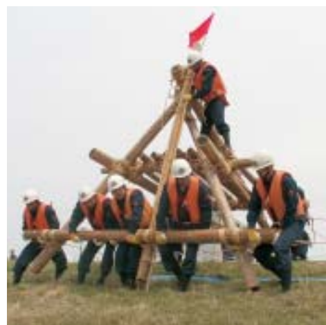
堤防の崩壊を防止する川倉工
