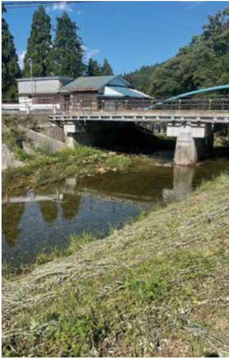
■抜本的な改修が待たれる入見内川
