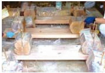
設置準備中の寄贈いただいたベンチ
