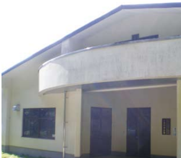
泥水流入により被害があった小波内浄水場
